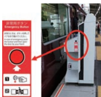
可動式ホーム柵非常用ボタン
